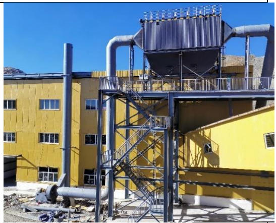
转载站除尘器
