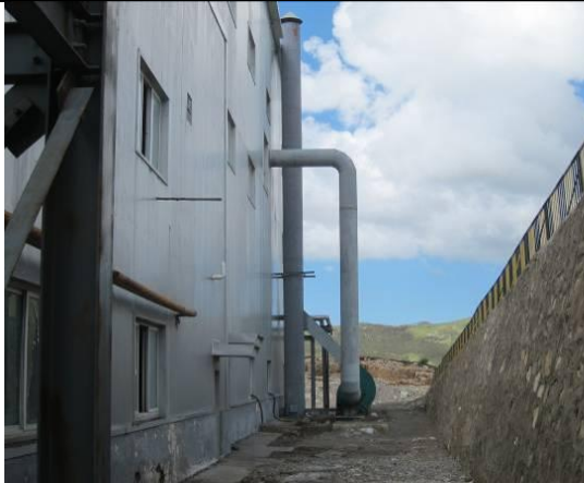
石灰乳制备车间排气筒
