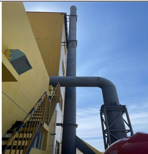
驱动站除尘器排气筒
