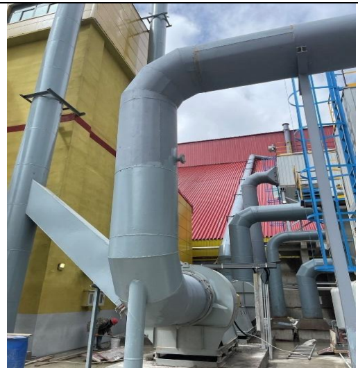
粗矿堆场底部、顽石破除尘系统
