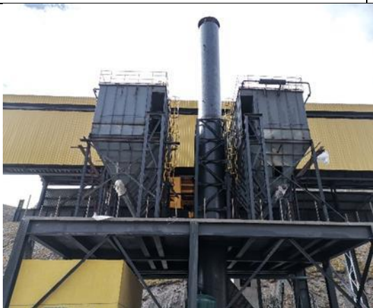
旋回破除尘器
